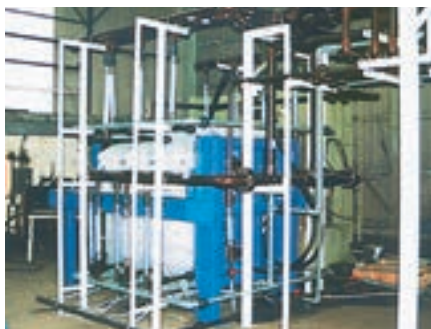
リサイクル設備
