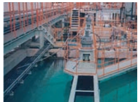
廃水処理設備
